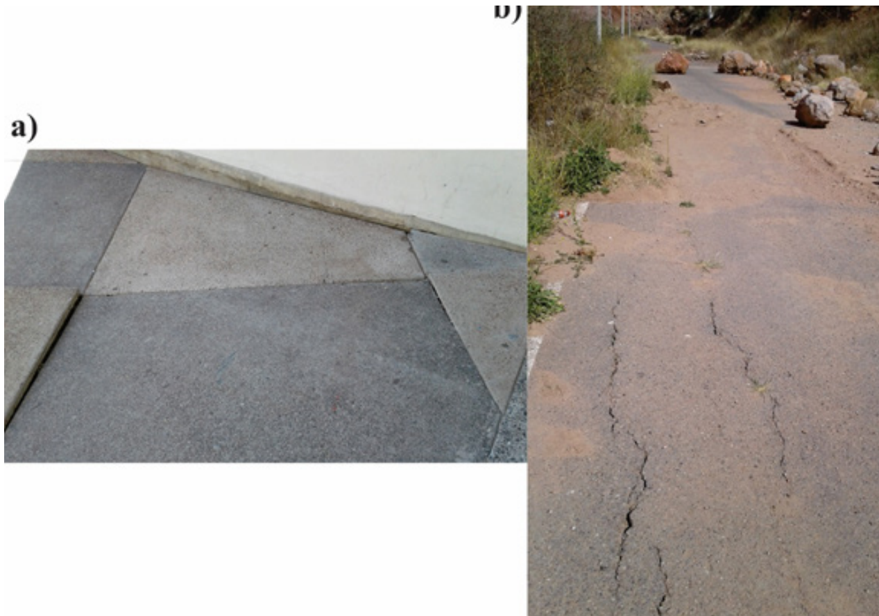
Figura 3. a) La socavación provocó el hundimiento de una parte de la entrada al edificio de la UACB; b) En el camino de la parte de abajo del edificio de la UACB (Fig. 1b) se observan la caída de bloques (posiblemente algunos son parte del relleno utilizado en la construcción) y fracturas de tensión perpendiculares a la pendiente.
