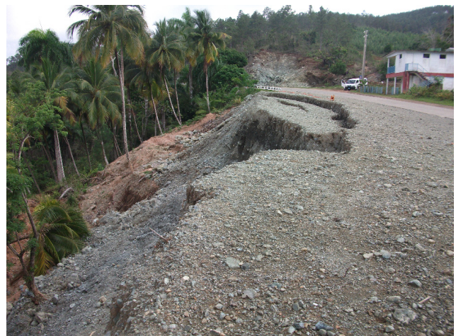
Figura 7b. Deslizamiento rotacional ubicado en Cagneybaje cerca del consultorio del médico de la familia.
