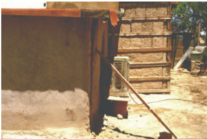
Figura 4. Casa en el Ejido Nuevo León, a la cual se le desprendió una pared como efecto del sismo del 1 de junio de 1999. La pared corresponde a un anexo construido con ladrillo de adobe.
