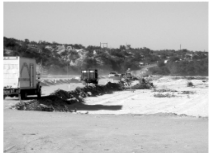
Figura 6. Cortes de la carpeta asfáltica de la carretera Federal No. 1 y 19, ocurrieron después del paso de los huracanes Isis (1998) y Juliette (2001). La fotografía muestra el arroyo de San Dionisio que corta la carretera cada año por las corrientes de lodo.
