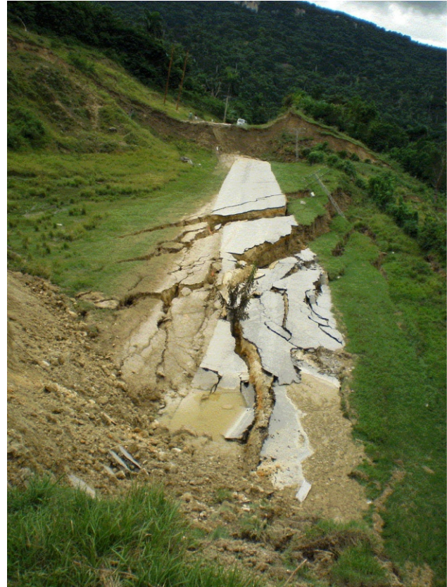
Foto 1. Deslizamiento del tramo de la carretera de La Güira a Boquerón (Sector a).
