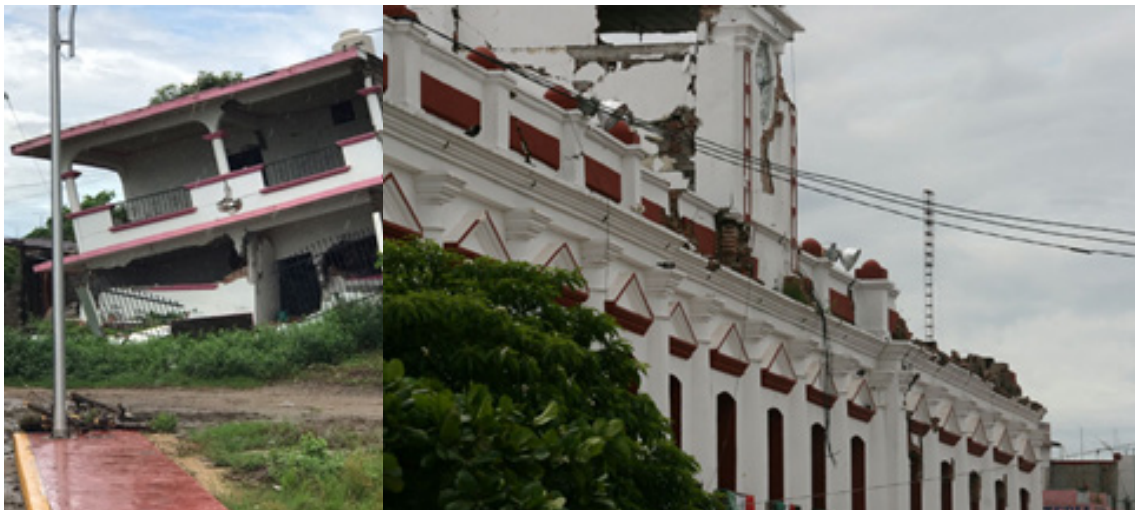
Figura 14. Fotografías muestran el daño causado por el sismo del 7 de septiembre en el estado de Oaxaca. Fotografías tomadas el 12 de noviembre del 2017.
