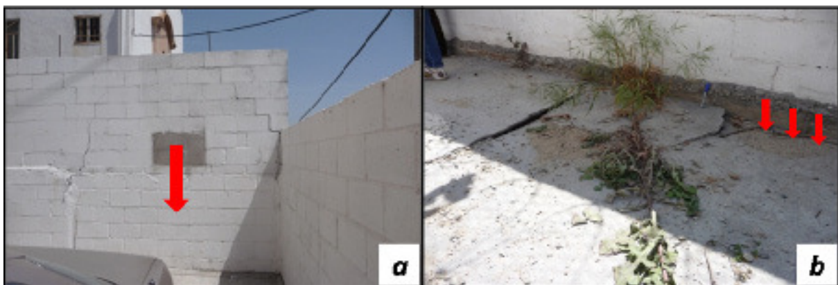
Figura 13. Ejemplos de hundimientos. a) privada Pirul y b) privada Alcatraces.
