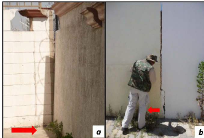
Figura 15. Ejemplos de movimientos. a) Barda perimetral en la privada Azucenas, Zona Oeste, con movimiento del piso hacia la derecha y hacia arriba. b) Grieta de separación localizada en el patio trasero de una vivienda en la privada De la Higuera, al NW de la Zona Este.
