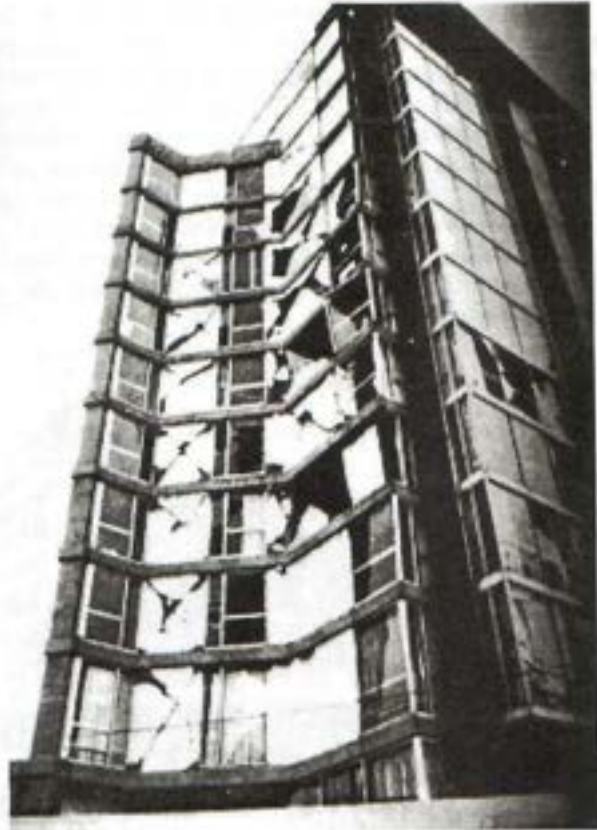
Figura 4. Rompimiento de muros
