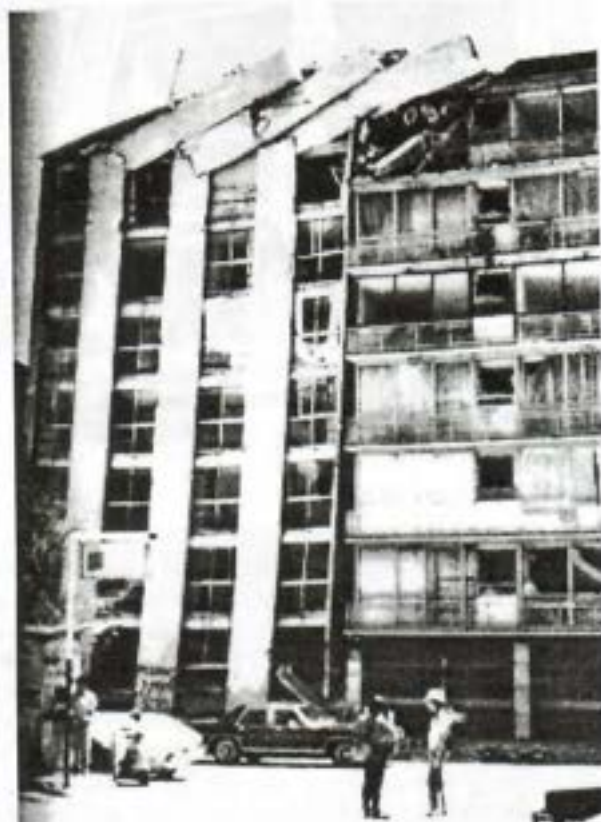
Figura 7. Daño por impacto
