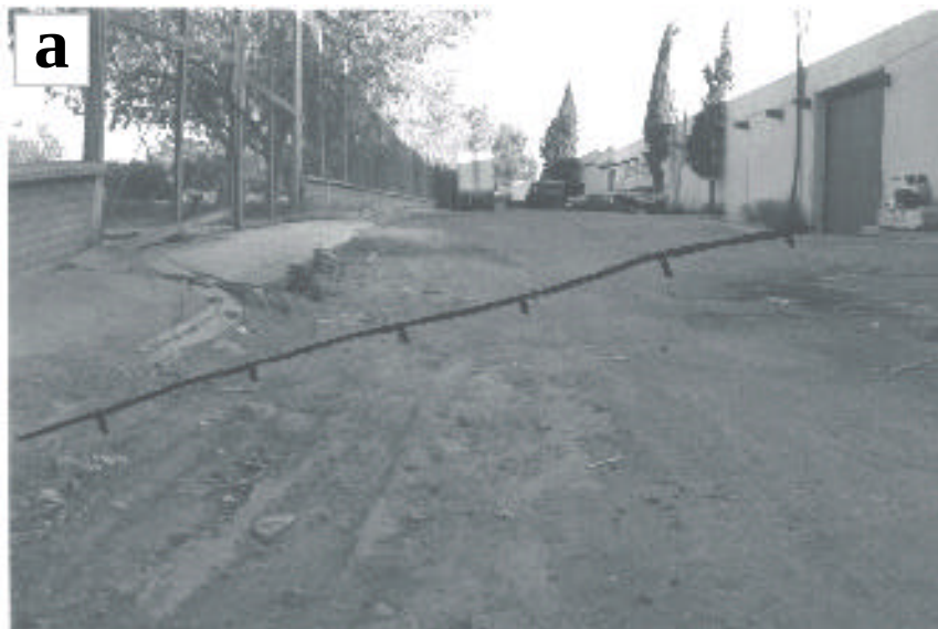
Figura 4.- Daños en propiedades cercanas a la Avenida 5 de Febrero, en la parte occidental de la ciudad de Querétaro, causada por hundimientos en el terreno sobre la trasa de la falla Santa Rosa Jáuregui-Olveras, con rumbo SSE. a) escarpe de 50 cm de alto en una de las calles afectadas (la línea punteada marca la zona deformada). La puerta que se observa a la derecha estaba originalmente al nivel de la calle, pero ahora se encuentra debajo de ese nivel; b) vista la sur de la Avenida 5 de Febrero mostrando una zona deformada (línea punteada). Nótese el desalineamiento del muro central de la avenida al intersectar con la línea punteada; c) daños en los muros de una construcción; d) daños en una bodega en la zona industrial al oriente de la Avenida 5 de Febrero.
