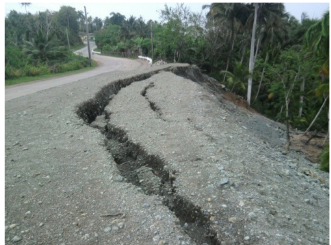
Figura 7a. Deslizamiento rotacional ubicado en Cagneybaje.
