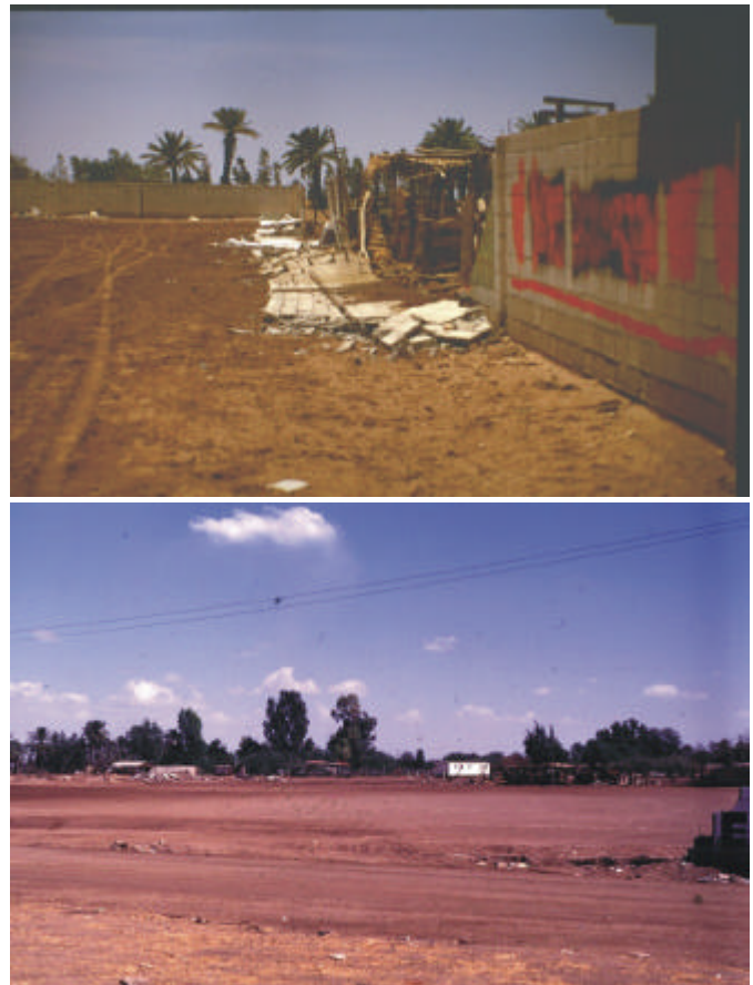
Figura 5a y 5b. Segmentos de bardas caídas en el campo de beisbol del Ejido Hidalgo. La fotografía 5a corresponde a los daños causados por el temblor del 1 de junio. La fotografía 5b fue tomada después del temblor del 10 de septiembre. Las palmeras que se observan en el extremo izquierdo son las mismas que están de frente en la fotografía 5a. Nótese que el segundo temblor derribó el resto de las bardas que quedaron paradas después del primer sismo.
