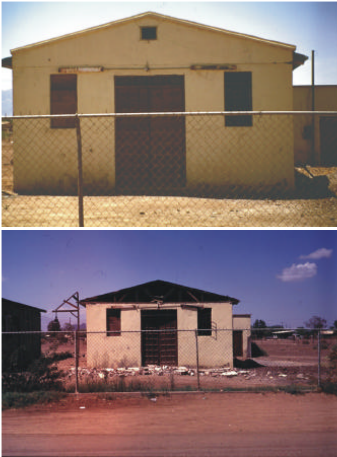
Figura 6a y 6b. Vieja iglesia católica en el Ejido Hidalgo. El sismo del 1 de junio cuarteó las paredes y mediante un pequeño giro separó el techo del resto de la estructura. En la fotografía 6b se muestra la misma iglesia después del temblor del 10 de septiembre. Se observa que únicamente se cayó un emplaste de la fachada de techo, en el frente del inmueble.
