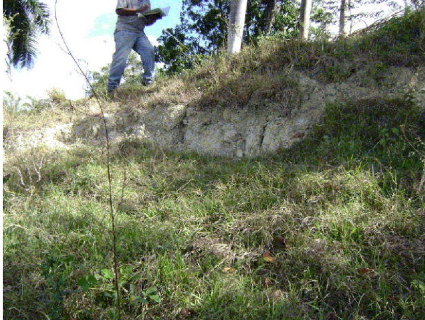
Foto 4. Escarpe principal del deslizamiento en el Zoológico de Piedra.
