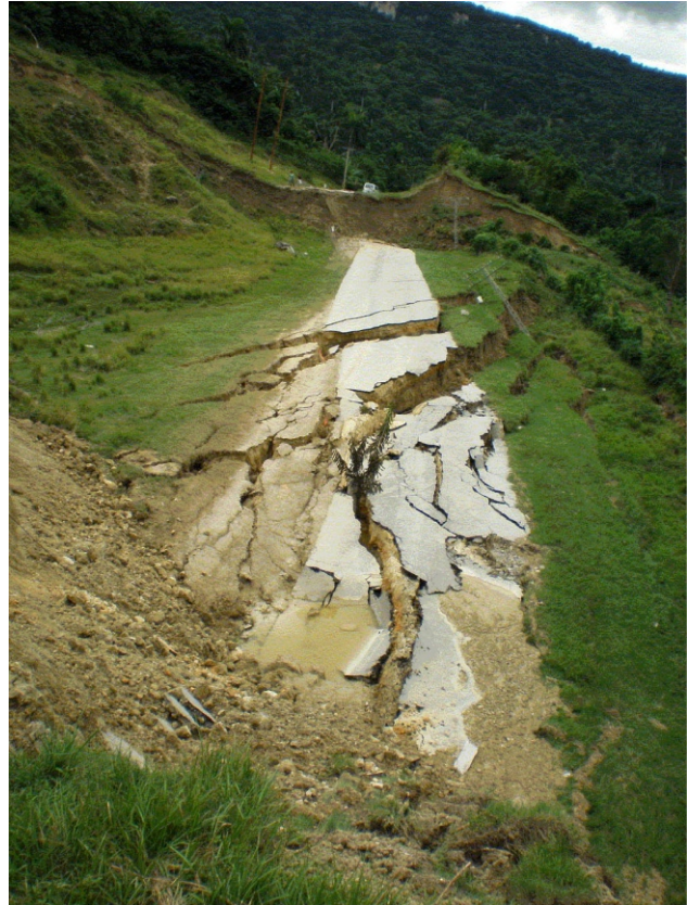
Foto 1. Deslizamiento del tramo de la carretera de La Güira a Boquerón (Sector a).
