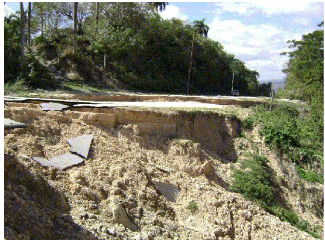
Foto 2. Destrucción de la carretera de La Güira a Boquerón por un deslizamiento (Sector b).
